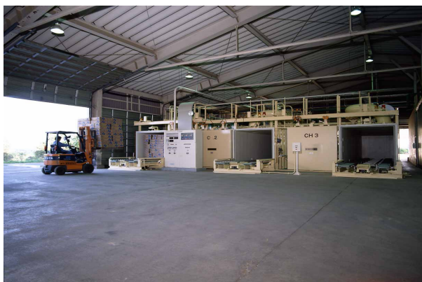
図4 真空冷却設備外観 1)
