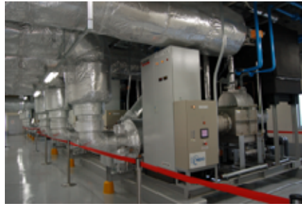
図8 空気冷凍システム「パスカルエア」 冷凍機ユニット（屋内仕様設置例）
