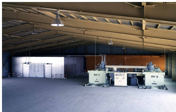
図3 真空予冷施設全体外観 1)
